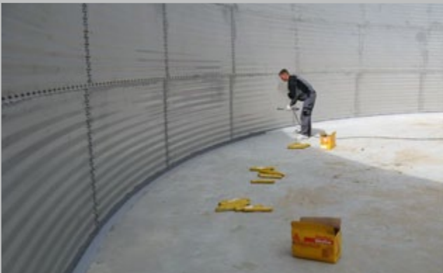
Внутренний монтаж емкости из волнистой стали Montaż wewnątrz zbiornika z blachy falistej
