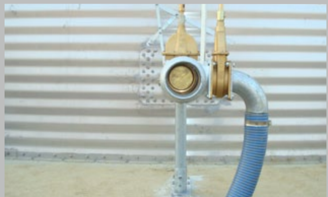
Заборная станция System opróżniania zbiornika
